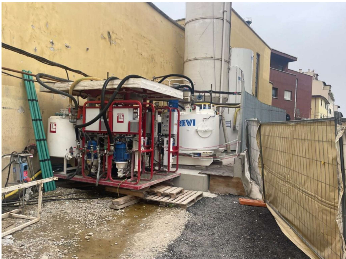
Figura 12 - Pozzo Via Cittadella
