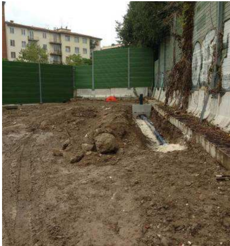
Foto 2 - Impianto di aggotamento acque
