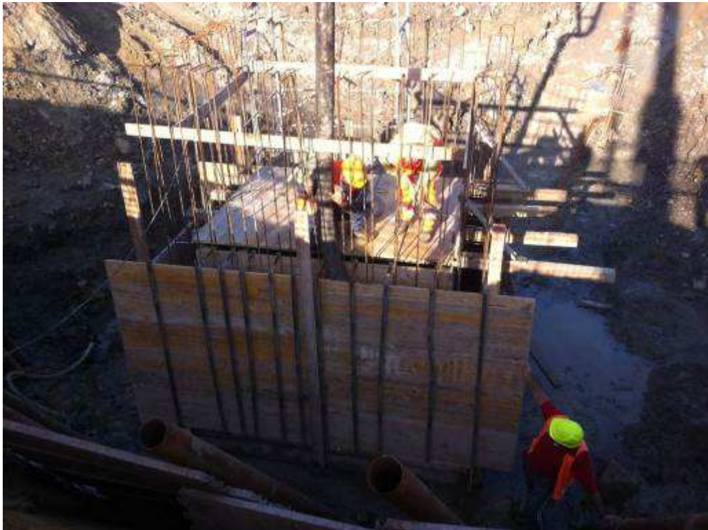
Foto 7 – Vasca di sollevamento Collina
