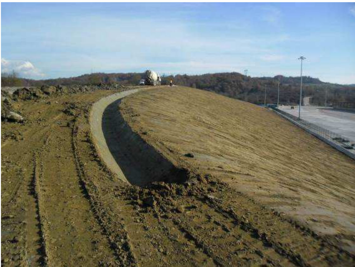
Foto 5 - Idraulica Ramo C del Terminal Bricchette
