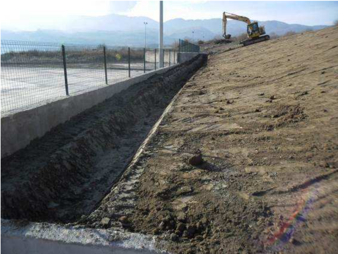
Foto 4 – Idraulica Ramo C del Terminal Bricchette
