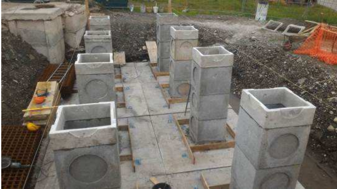
Foto 1 – Passi d'uomo Vasca di Prima Pioggia – NC177
