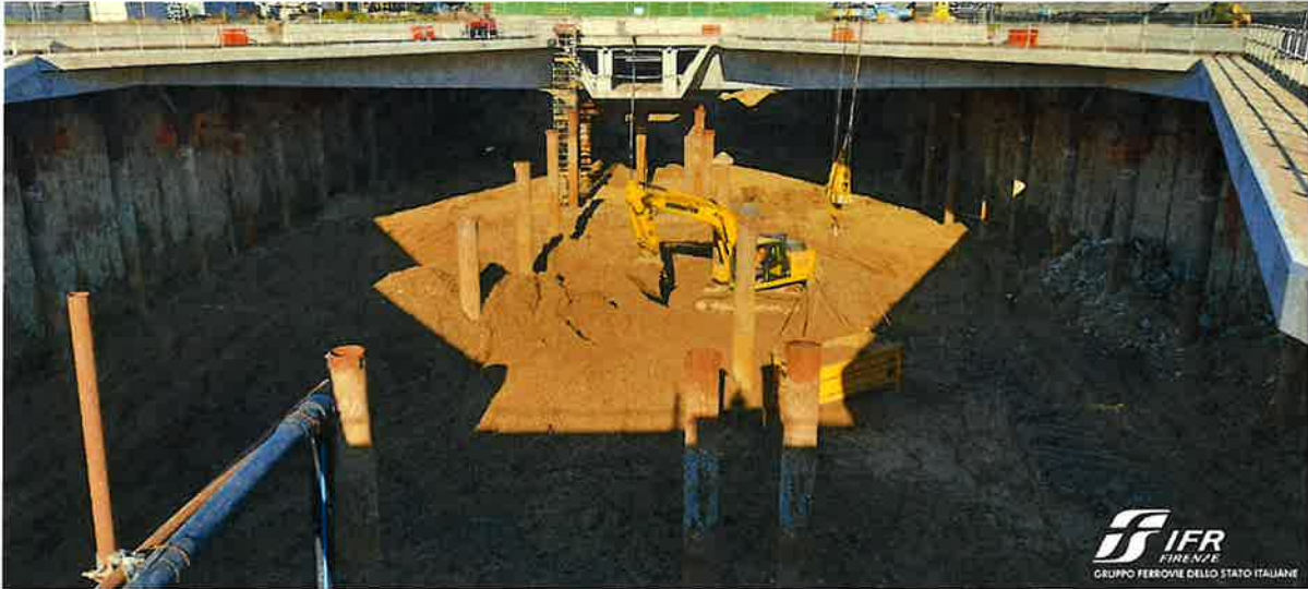
Foto 01 – attività di scavo e caricamento tramite Gru (2° strato su terra – da quota 37 m s.l.m. a quota + 35 m s.l.m.)
