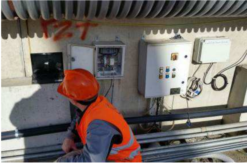
Foto 2 – Manutenzione Trimestrale sonde continuità di falda
